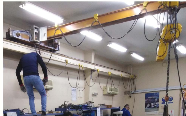
رفع اشکال مکانیکی از حرکت طولی جرثقیل اتاق کالیبراسیون
